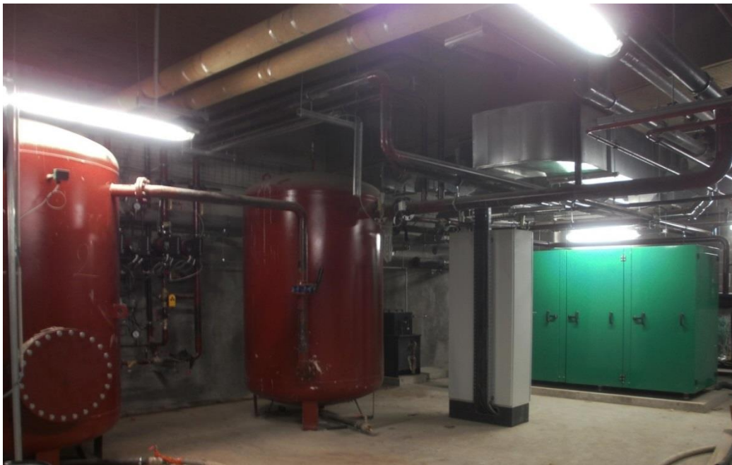
Figure 6.15 : Groupe de cogénération (en vert au fond), cuves de stockage (en rouge à gauche) et enchevêtrement de tuyaux au plafond, en sous-sol de l'îlot Hikari – Photo prise par l'auteur - Avril 2015
