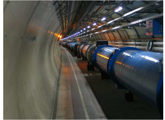
FIG. 2.3 – Dipôles installés dans le tunnel du LHC [30]
