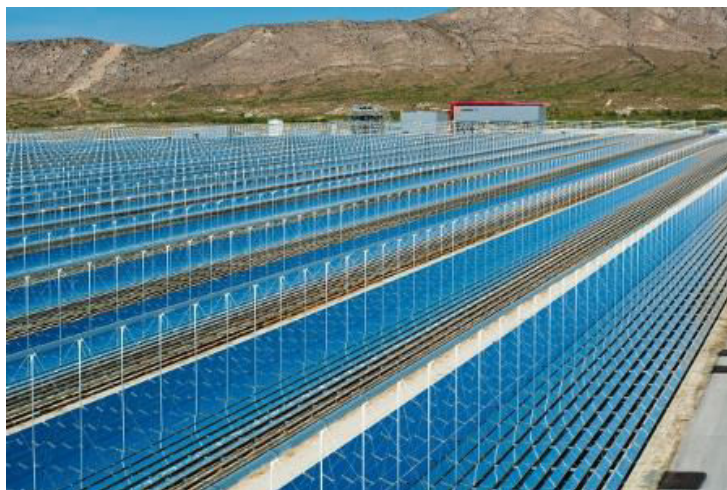
Figure 1-11 : Vue de la centrale PE2 (source : Novatec Solar)
