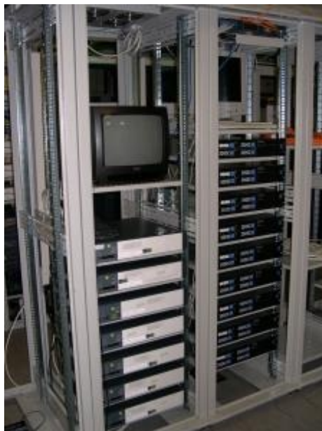
Une baie de serveurs
