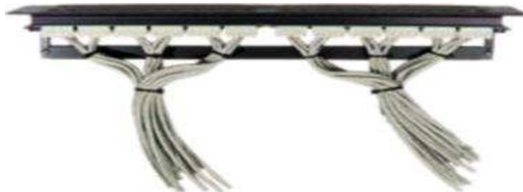
Vue du dessus d'un tableau de connexions
