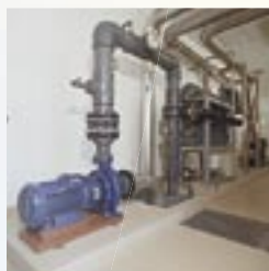
■ Contrôle de pompe
