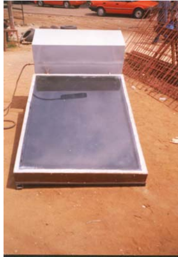
Chauffe-eau de type thermosiphon produit localement (hôpital de Grand-Bassam)
