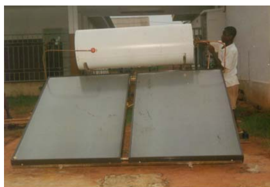
Chauffe-eau de type thermosiphon importé (hôpital de Dimbokro)
