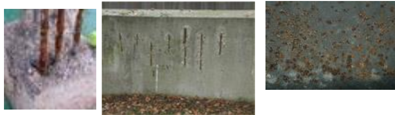
Exemples de corrosion marine du béton.
