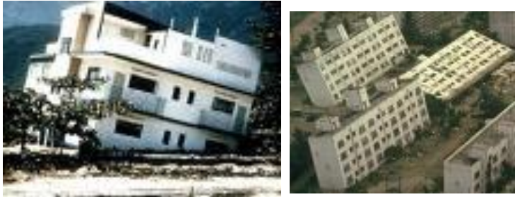
Liquéfaction du sol, après un séisme, quand les maisons sont construites sur un sol mou et riche en eau, perdant sa cohésion sous l'effet d'une secousse.
