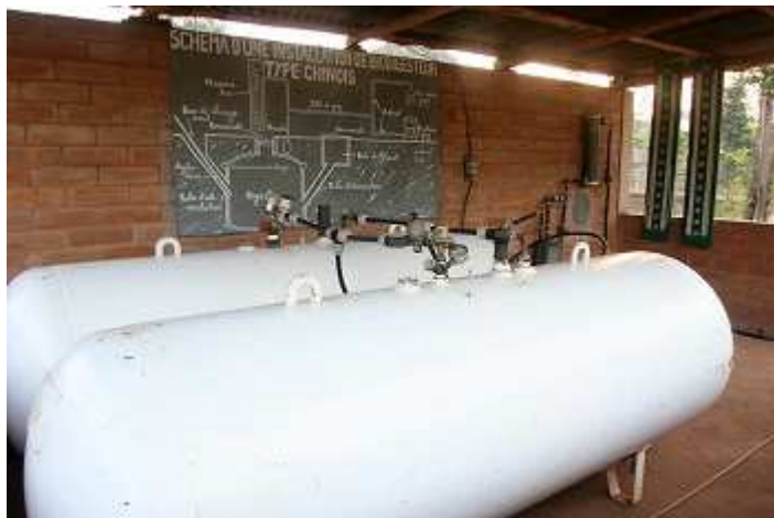
Unités de stockage du biogaz ↑→ ↑ Au fond, on aperçoit les manomètres
