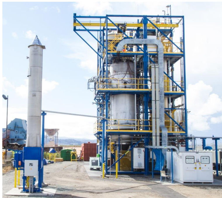
Figure 25 : Installation SEAPORT I de Monolith Materials aux Etats-Unis pour la production de noir de carbone et d'hydrogène, développée en partenariat avec Mines ParisTech
