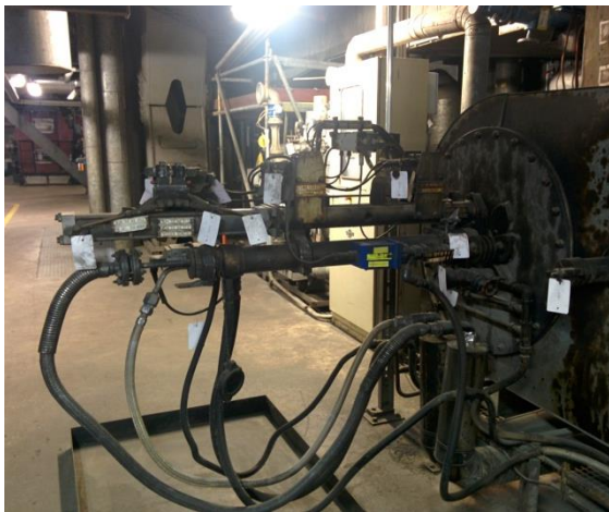
Figure 14 : Canon à fioul monté sur un brûleur à charbon pulvérisé dans la centrale de Zolling en Allemagne
