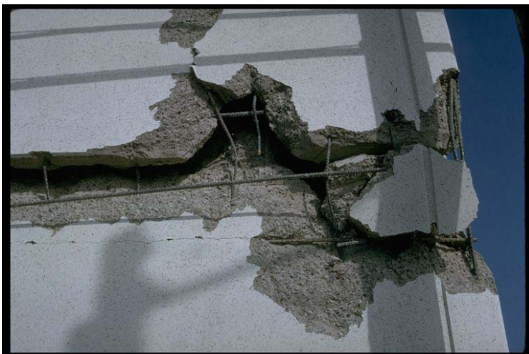
Amorce de cisaillement de l'extrémité d'un voile (Séisme d'Anchorage, 1964) (Document Karl – V. Steinbrugge)
