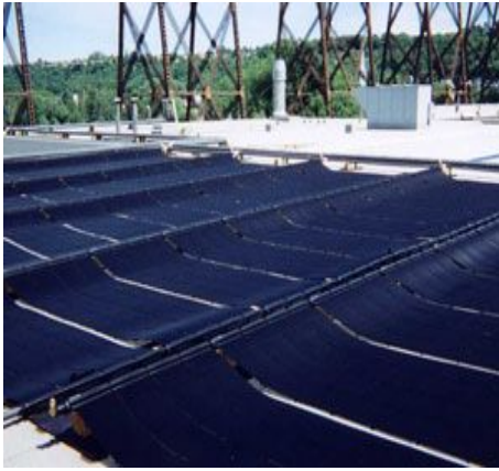
Fig. 2.20 Capteurs solaires sans vitrage (capteur moquette). [19]
