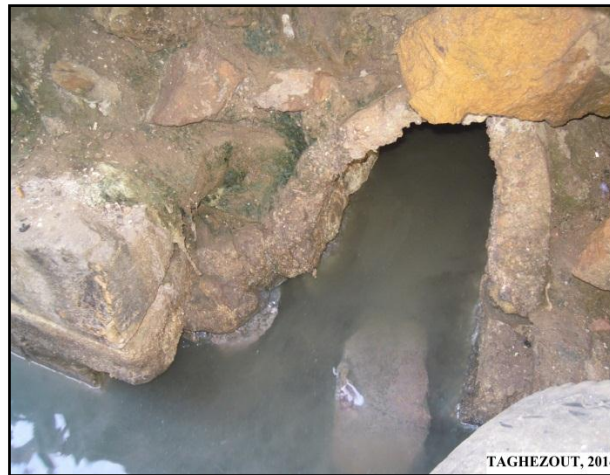
Figure 30 : Rejet du Port d'Oran
