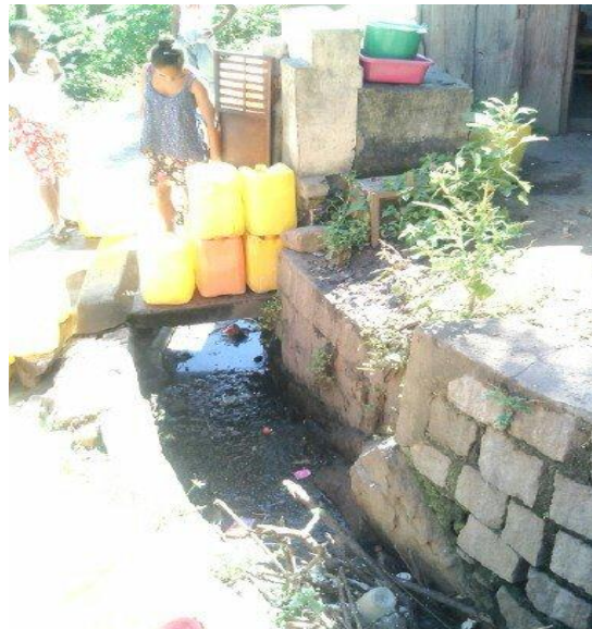
Figure 9: Canal d'évacuation d'eaux usées passant près d'une borne fontaine.
