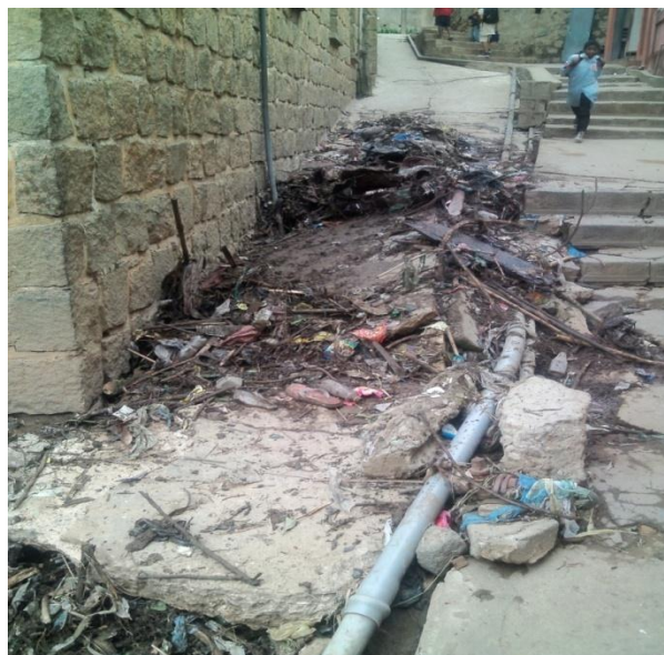
Figure 6 : Photo du débordement des déchets solides du réseau d'Ankadilalana
