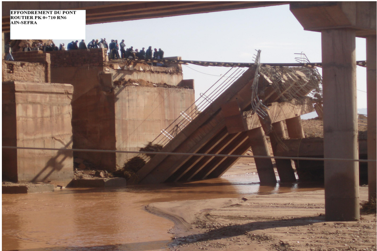
Photo I.11: effondrement du pont routier à PK 0+710 RN6 –Ain Sefra
