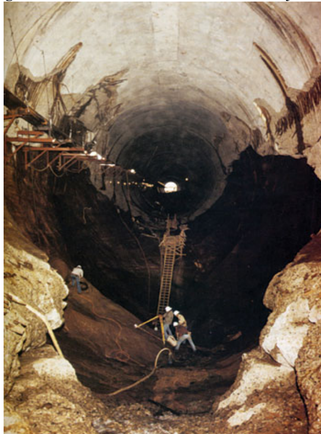
Photo I.7 : Les dommages dans le tunnel d'évacuation de barrage Glen Canyon
