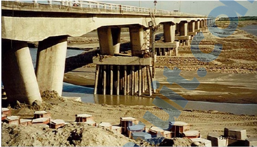
Photo II.1: Un exemple d'affouillement autour des piles de pont [23]
