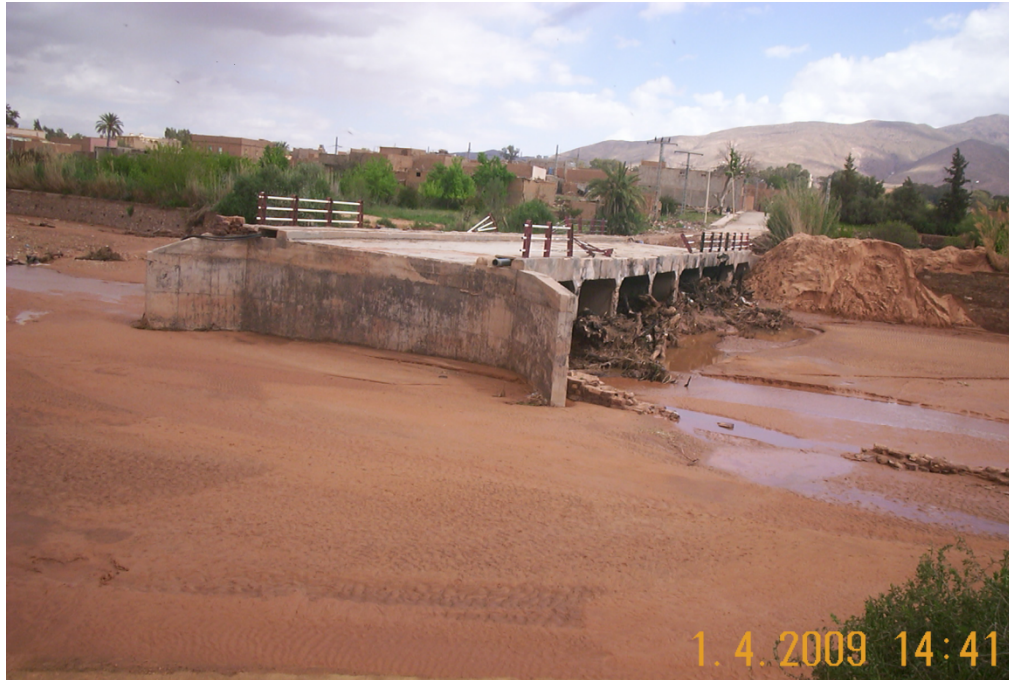
Photo I.10: Affouillement des remblais d'accès d'un dalot en Algérie (Accumulation des débris et réduction de la section d'écoulement).
