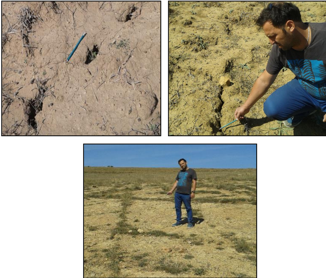
Figure I.9. Première phase d'érosion en nappe (Photos prises par Morsli et Kazi après une averse d'automne 2018).
