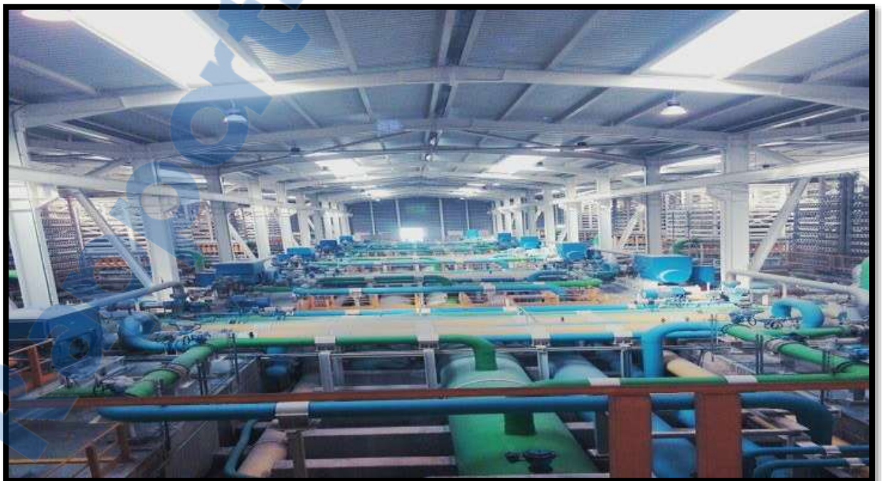
Figure II.4 : Station de dessalement de Hounaine [24].
