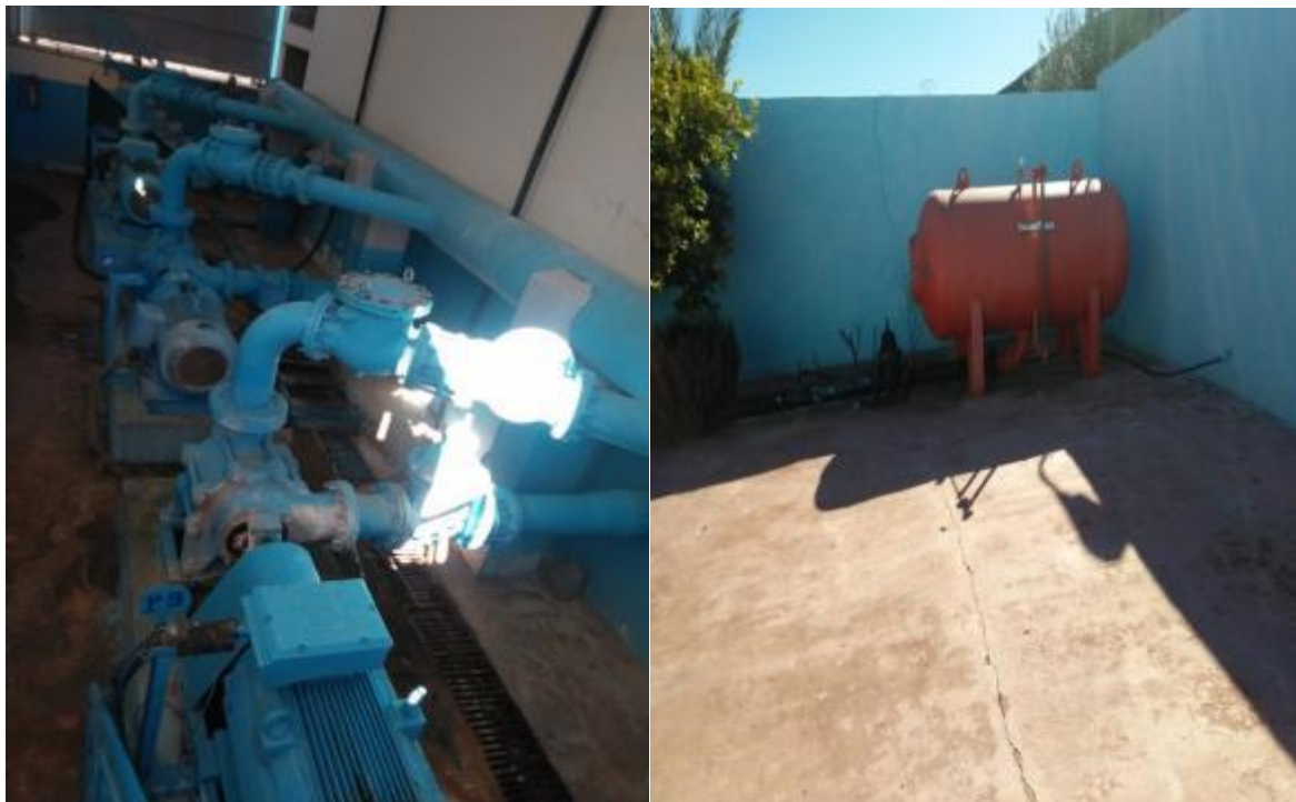
Photo III.2: La station de pompage Zouia 1 et l'anti bélier.
