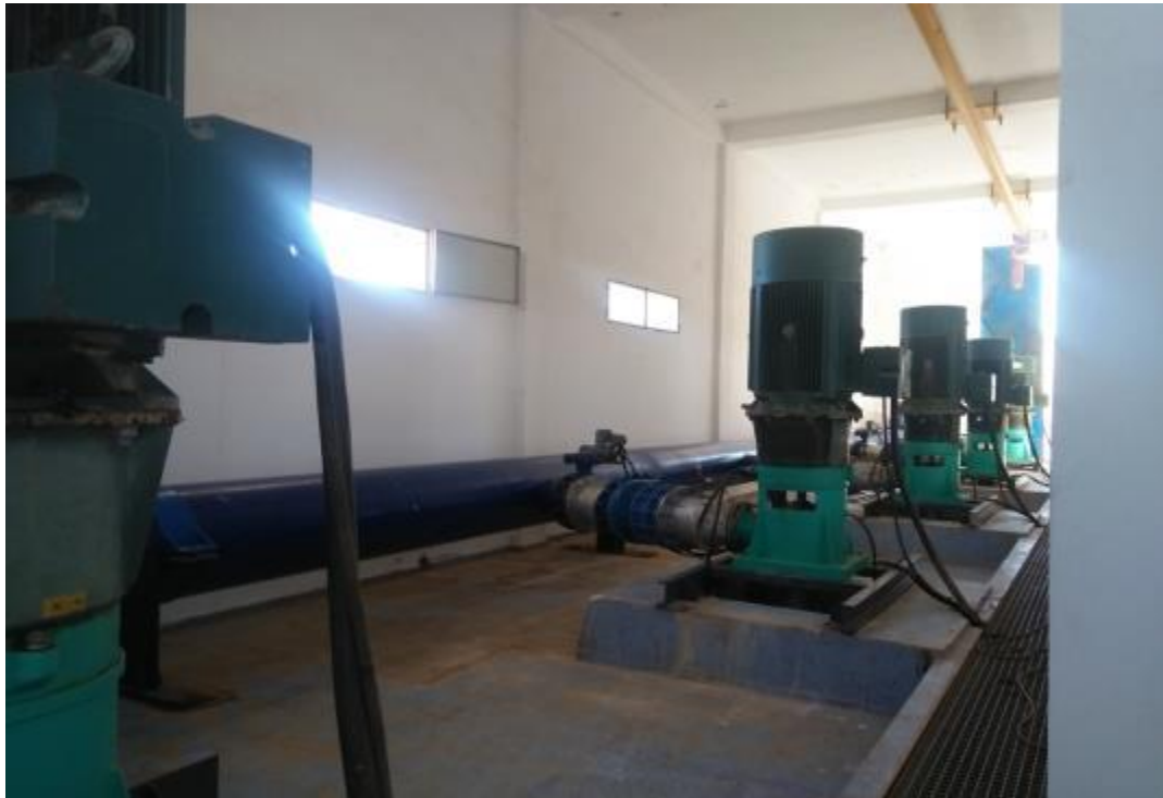
Photo III.1 : La station de pompage Zouia 2.
