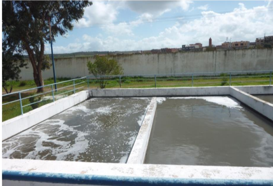
Figure III.14 : Photo de bassin de chloration.
