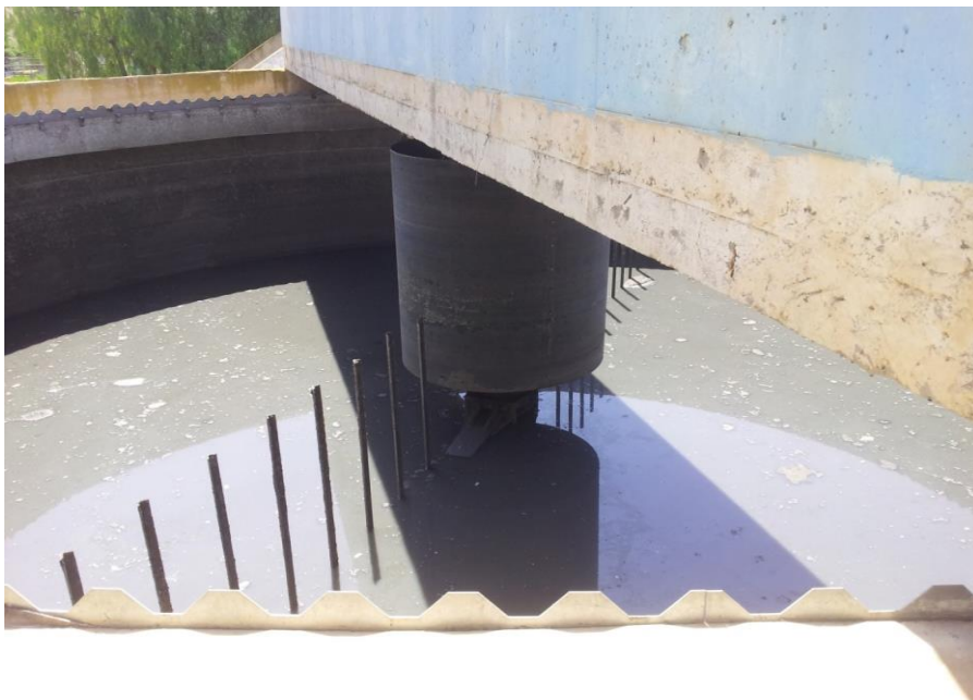
Figure III.15 : Photo de l'épaississeur de boue.
