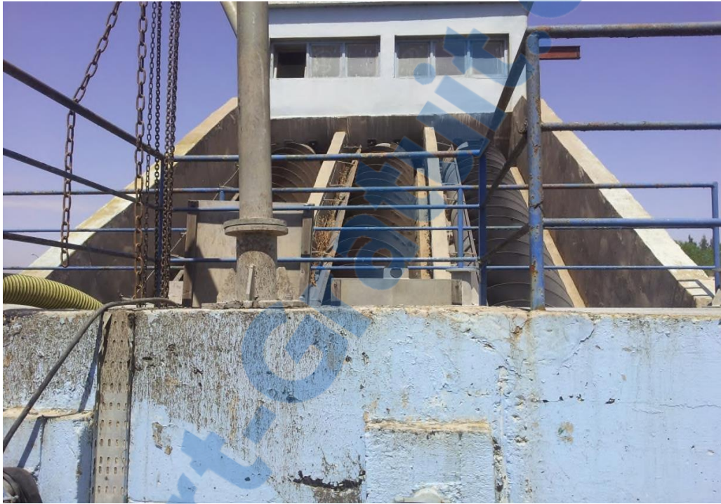
Figure III.13 : Photo des vis de recirculation de boue.
