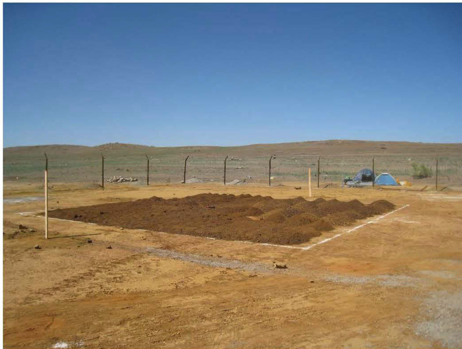
Figure G.7 Installation des rejets grossiers de Kettara (bris capillaire).
