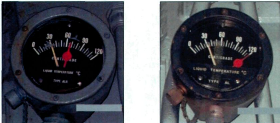
Figure 16 : Capteurs de température installés sur un transformateur de puissance [25].
