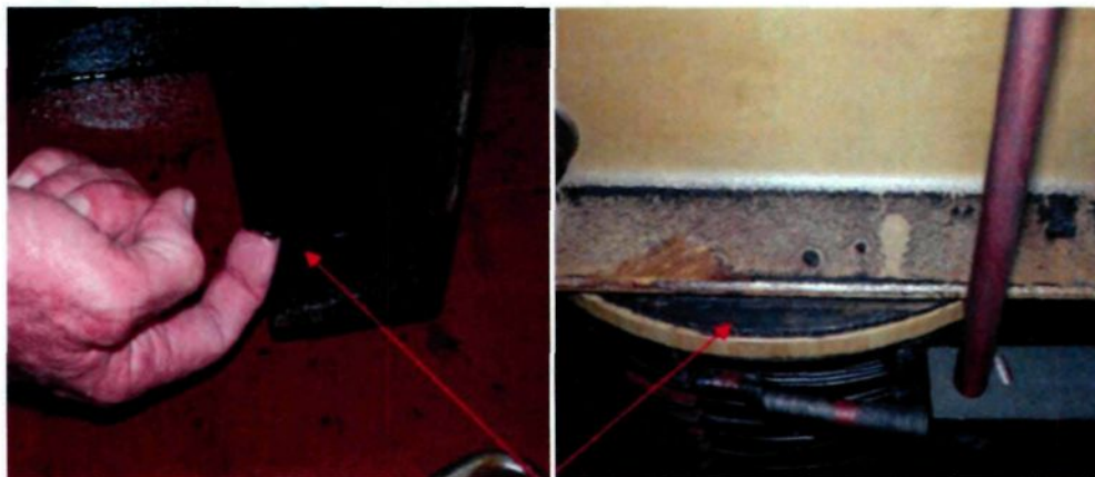
Figure 6 : Exemple de boues présentes dans un transformateur [20].
