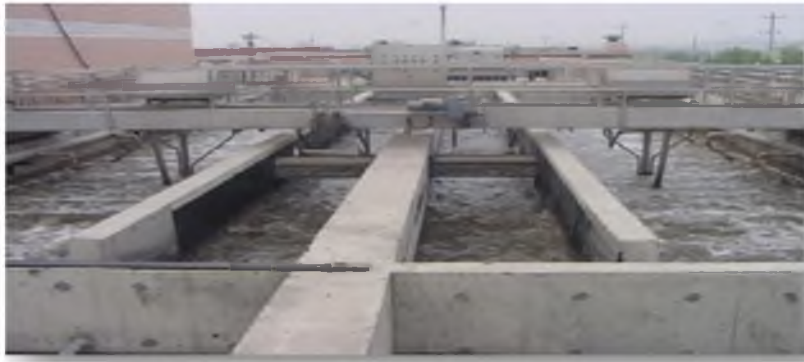
Figure III.5: bac de dessablage et dégrillage combinées
