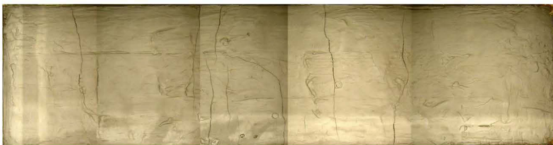
Figure 5-1 : Photographie de premières fissurations apparues en surface de la couche 10 après 6h de son dépôt.
