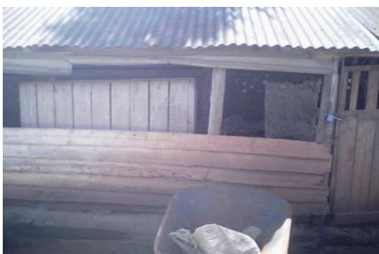
Figure 13 : Bâtiments construits avec des matériaux fragiles
