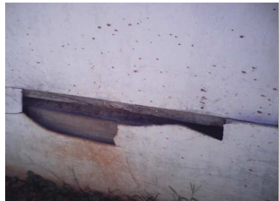
Figure 12 : Mur présentant de fissures
