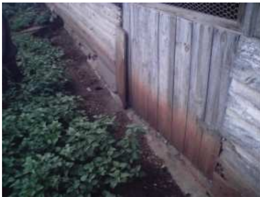
Figure 11 : Végétation encombrant près des bâtiments
