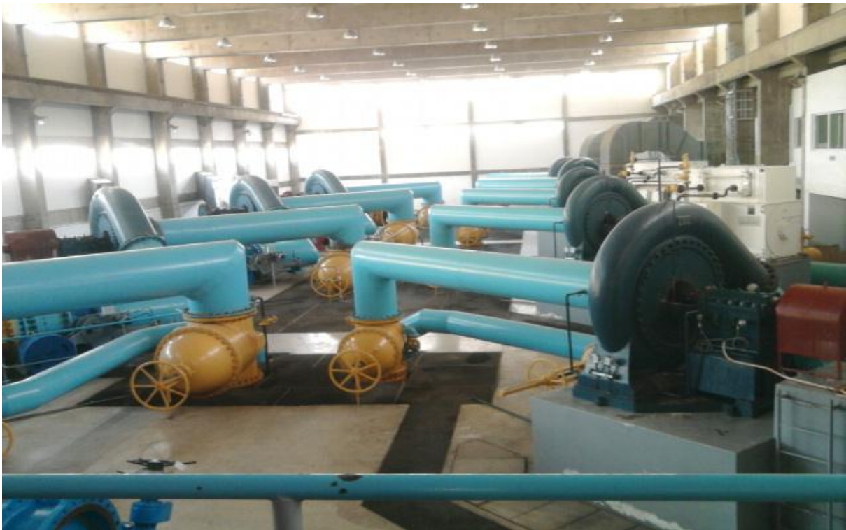
FIGURE 14 : Groupes de pompage constituant la station de pompage du bouregreg.
