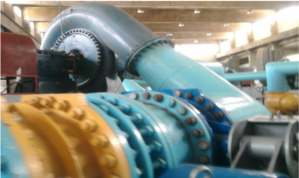
FIGURE 16 : Conduite de refoulement.
