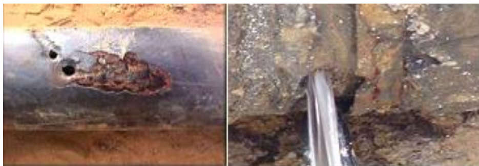
Fig 1. 6 Etat d'un pipeline endommagé
