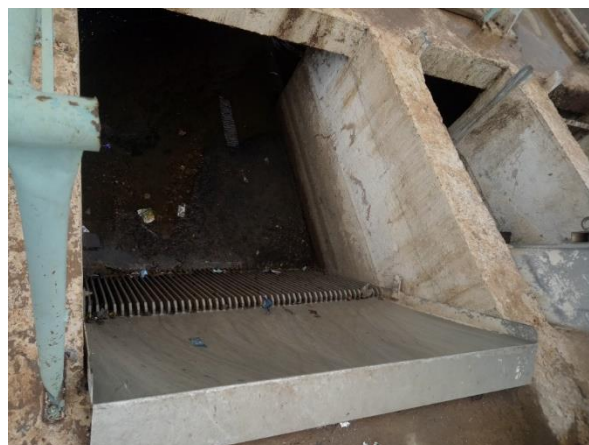
Figure 26 : Grille grossière manuelle
