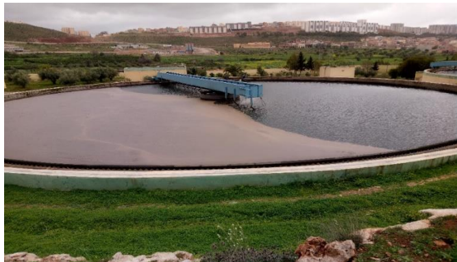
Figure 30 : Photo d'un clarificateur
