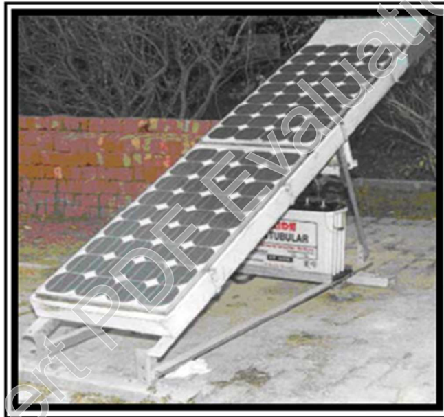
Figure 3-6 : banc d'essai du capteur solaire hybride PVT à air [26]
