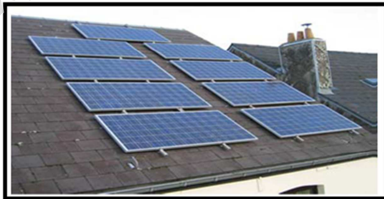
Figure 1-12: Exemple de panneaux PV connectés au réseau et montés sur la toiture d'un bâtiment
