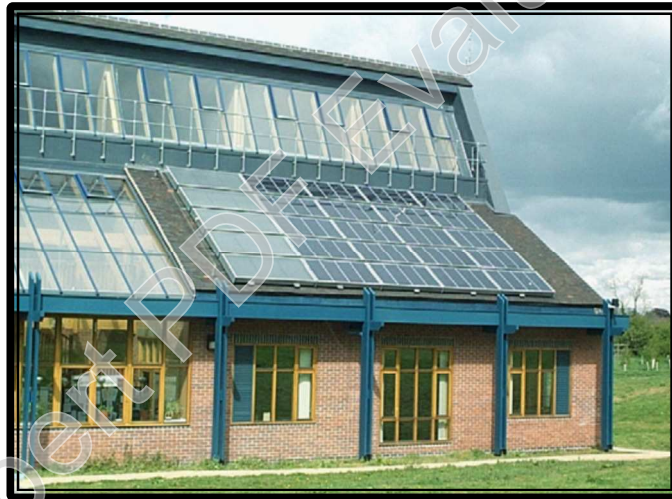
Figure 3-5: Capteurs solaires combinés intégrés à la toiture du Brockhill Environment Center
